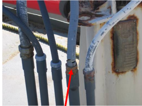
Broken conduit on davit wiring
